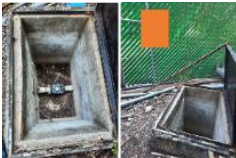
Campus Chiapas Área para el gabinete de telemetría
