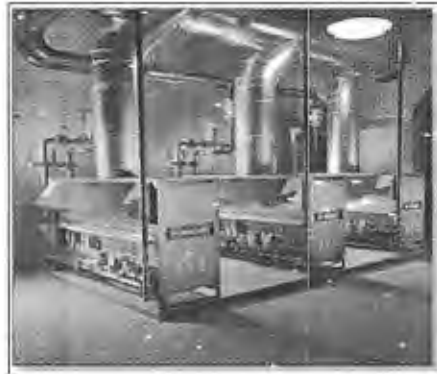
Figura 3.24 - Ductos de aire acondicionado [X]
