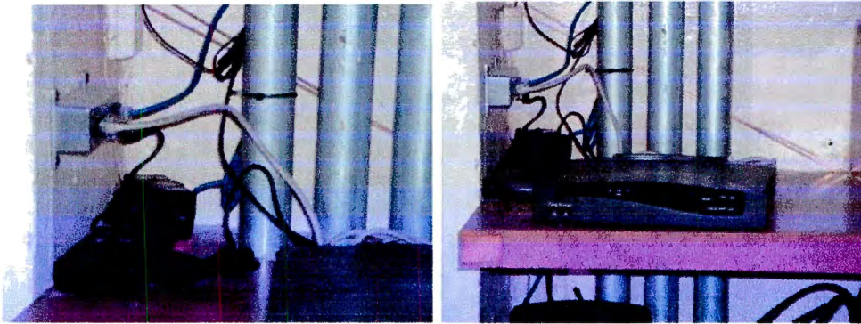
Figura: 1.2. Sitio hot spot operando sin cumplir un proceso de seguridad.
