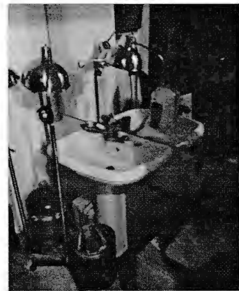
Imagen 9: Lavabo de sanitario
