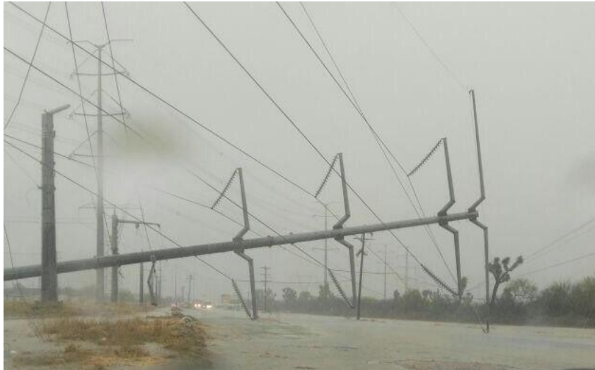
Imagen 1. Torre de 115,000 voltios caía sobre autopista hacia el aeropuerto durante tormenta del 3 de Agosto de 2017 por la tarde. Fuente: anónimo Twitter
