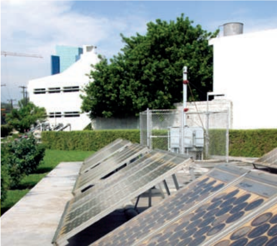
Celdas fotovoltaicas para producir energía eléctrica.
