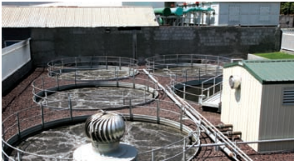
Planta biológica de tratamiento de agua.
