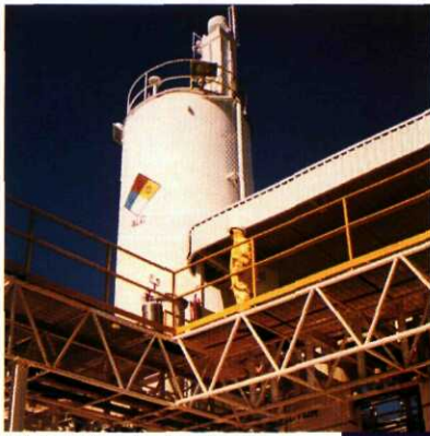
Planta de Neutralización, Mina, N.L.
