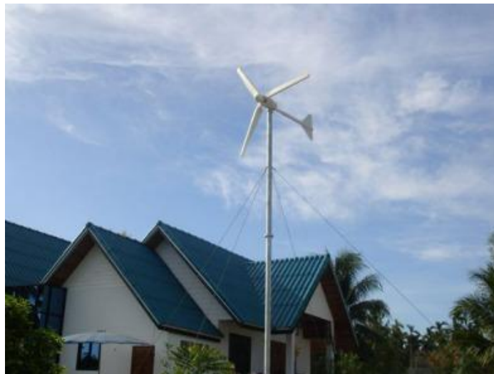
Figura 15 Generador eólico de baja escala para uso doméstico
