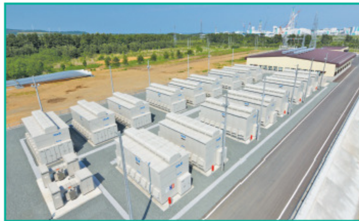
Fig. 3.4 Instalación de baterías NaS de 34 MW, 245 MWh.
