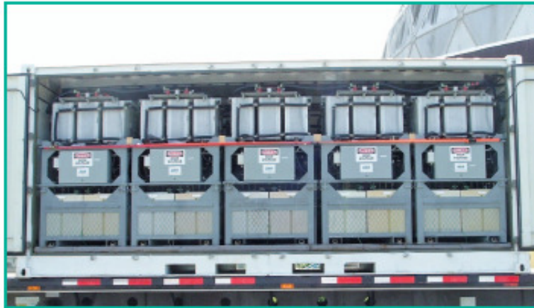
Fig. 3.5 Sistema de baterías de flujo de bromuro de zinc (500 kW).
