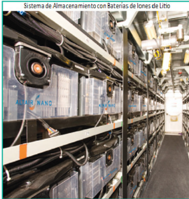
Fig. 3.6 Sistema de batería de iones de litio de 1000 kWh utilizadas para la regulación de frecuencia en una empresa eléctrica.
