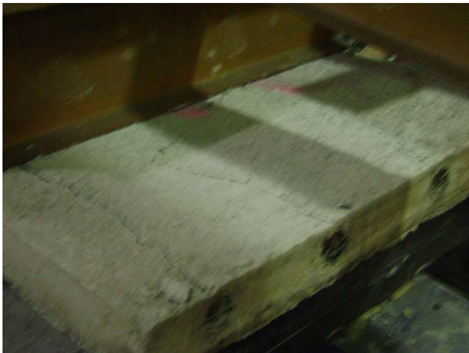
Foto 6.11. Grietas longitudinales presentes en las losas de 10 cm de espesor, debido al poco recubrimiento provisto para el bambú.
