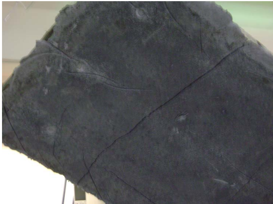
Foto 6.13. Grieta transversal en losa de 15 cm de espesor y reforzada con 5 bambúes. Vista Inferior de la misma.
