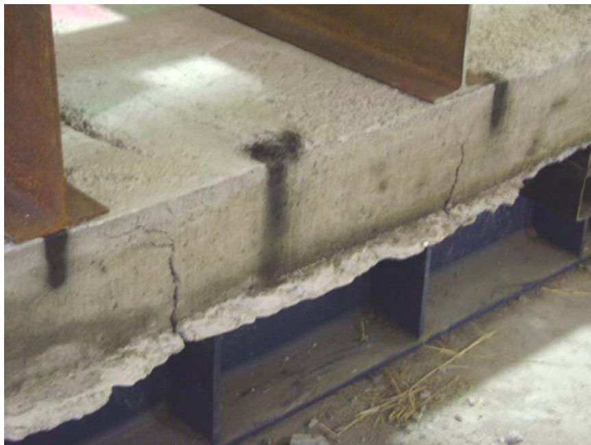
Foto 6.9. Falla por corte en losas de 1.5 metros.
