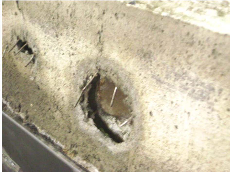
Foto 6.12. Falla por adherencia del bambú dentro del concreto.
