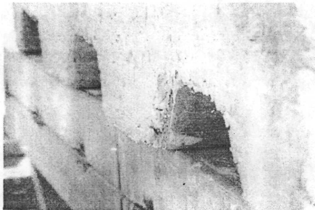
Foto 26. Deslizamiento de extremo entre lámina y concreto
