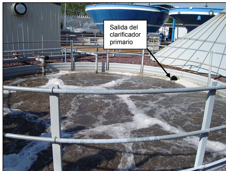
Figura 3.1 Planta de tratamiento del ITESM, salida del clarificador primario
