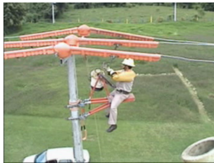
Figura 1. 1 Estructura TS30 (Tomado de CFE, 2004)
