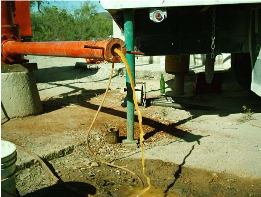
Foto 3: Aforo del Pozo
