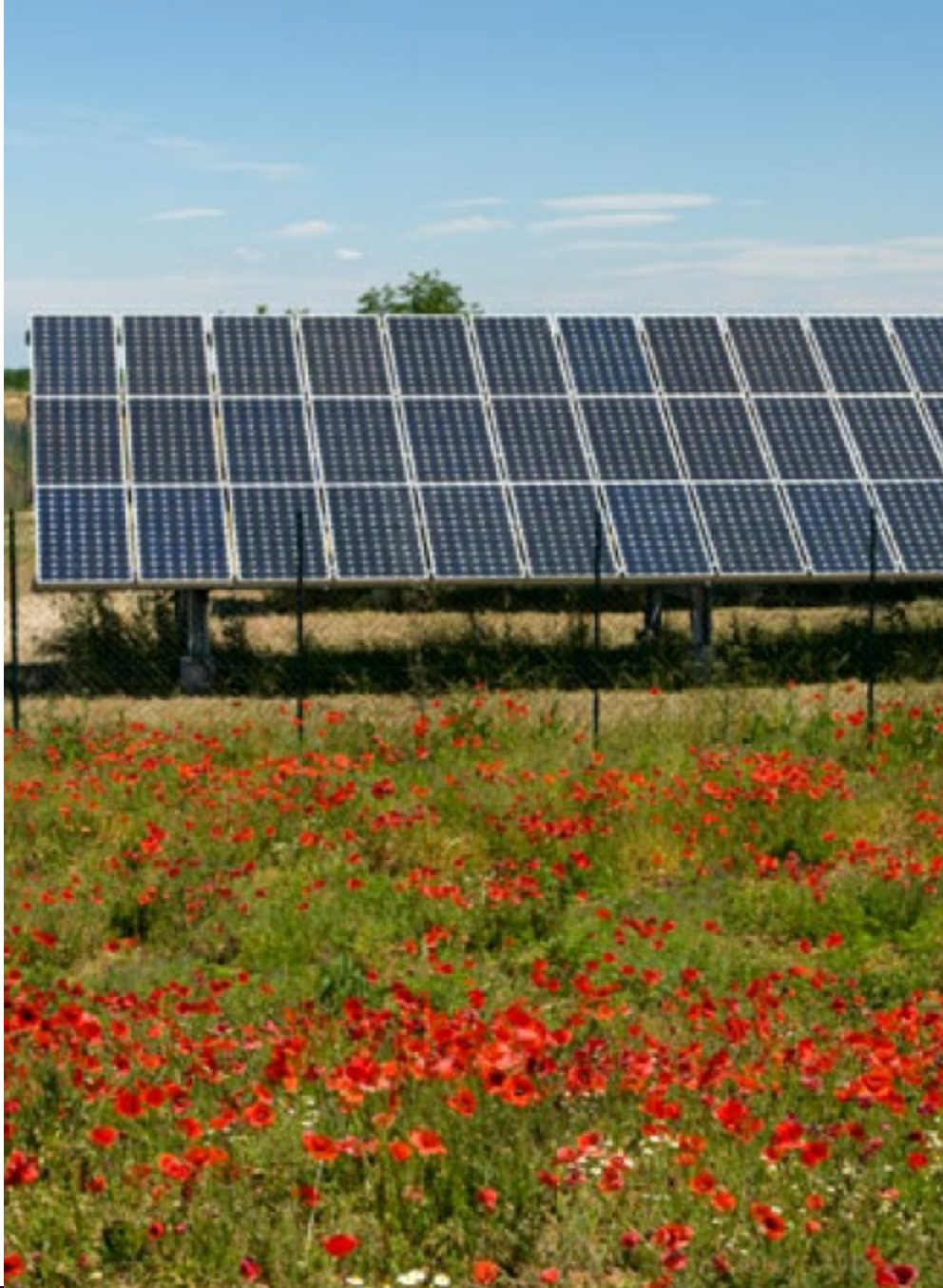
Figura 23. Celdas fotovoltaicas produciendo energía por medio del Sol.
