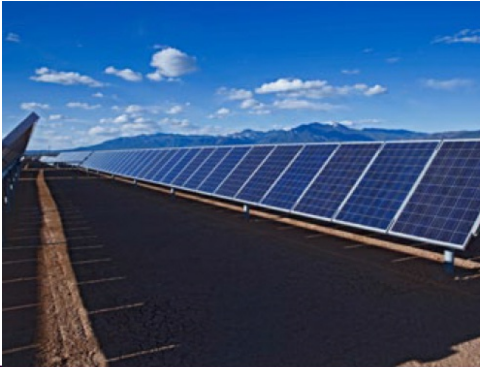
Figura 24. Celdas fotovoltaicas a gran escala.
