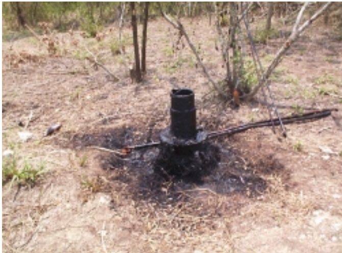
FIGURA 3. Pozo abandonado con emanaciones de hidrocarburos y
