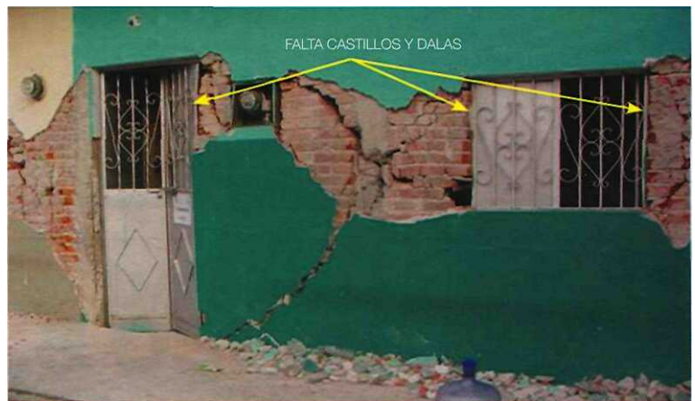
FIGURA 2. DAÑO EN UNA VIVIENDA DE MAMPOSTERÍA DEFICIENTEMENTE CONSTRUIDA.
