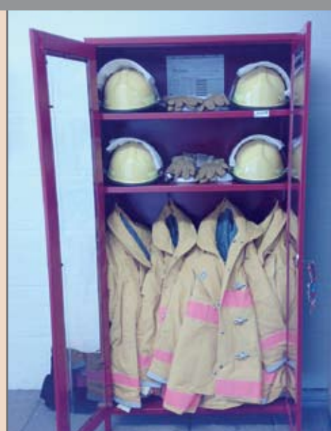
>Equipo contra incendios
