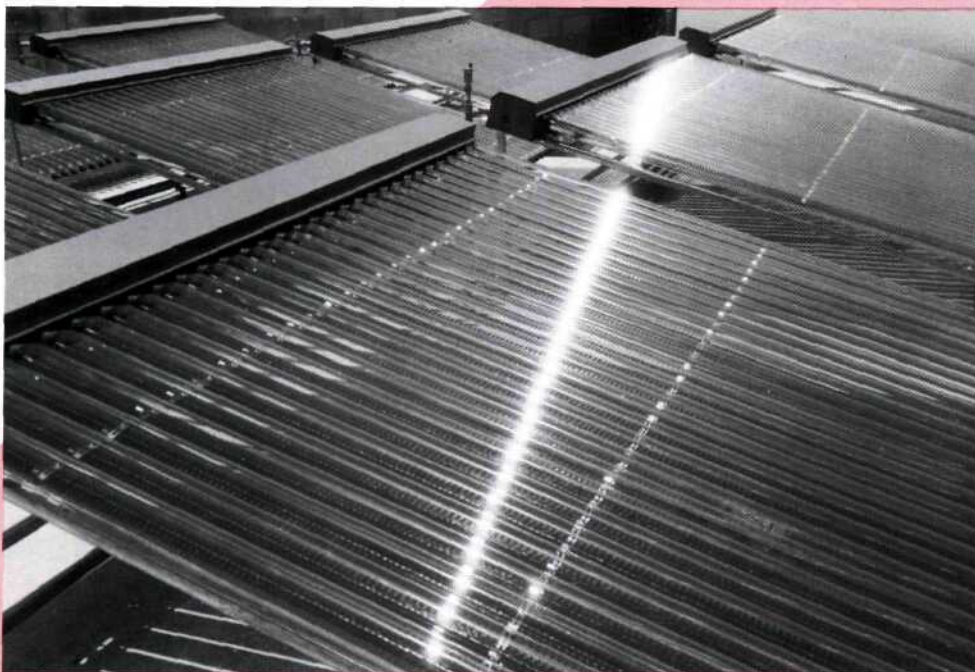
Conjunto de tubos al vacío para operar un sistema de aire acondicionado en el Laboratorio de Energía Solar
