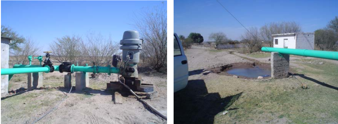
Gráfico No. 9 Tubería que conduce el agua obtenida del pozo que abastece al Ej. Virginias.
