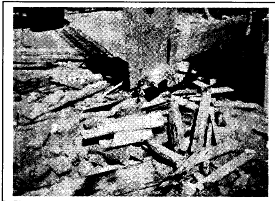
Figura 8: Congestionamiento de la obra.
