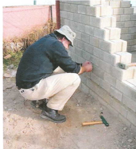
Figura 32. Ensamble tipo junta - candado y apilado en seco de los BTC Hydraform. Fuente: Hydraform África, 2007.
