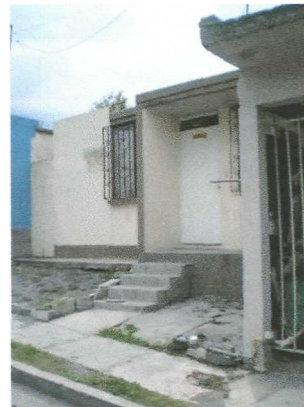
Figura 64 Fachada deteriorada. Fuente: Imagen del autor, 2007.
