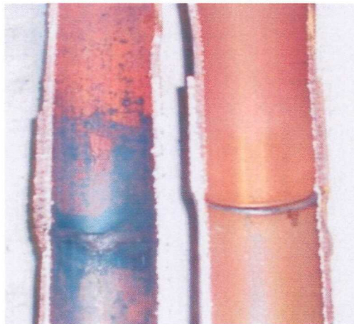
Fig. 2.11 Unión sin nitrógeno durante el proceso de soldadura (izquierda) y unión que utilizó nitrógeno en el proceso de soldadura (derecha).
