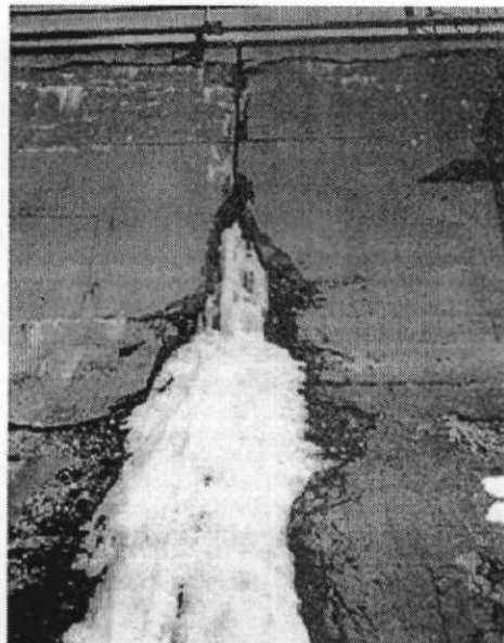
Figura 2.5, fallas por infiltración de agua en el concreto.
