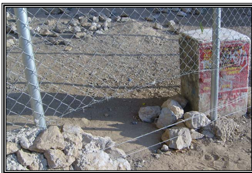
Figura 8. Malla dañada en la entrada de la Cueva la Boca Fuente: Dr. Guillermo Gándara Fierro, Junio 2005
